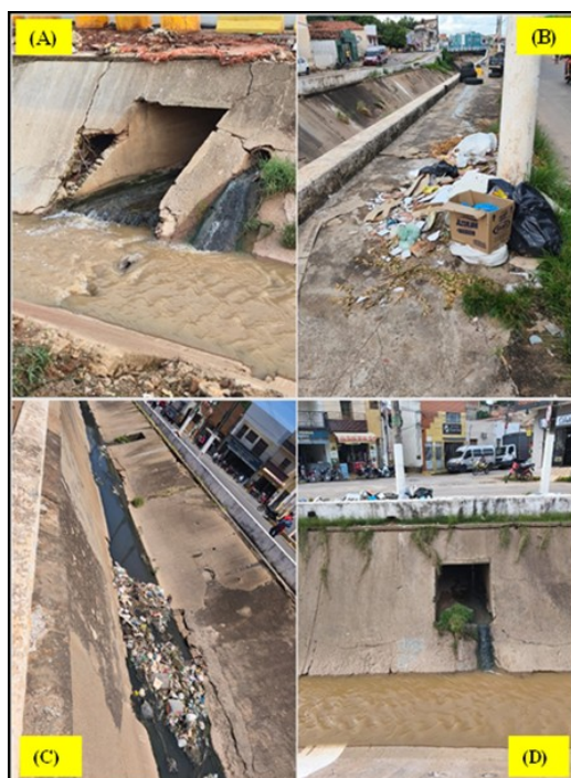
Figura 5: Lixo e esgotos em trechos do canal
