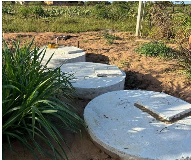
Figura 3: Bioágua implementado pela Cáritas Diocesana de Caicó em comunidades rurais da Serra de Santana/RN
